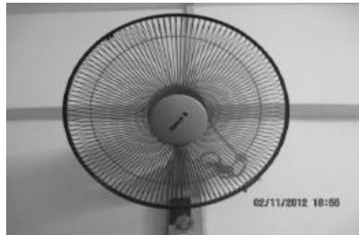
Fig. 3: Fan for air circulation
